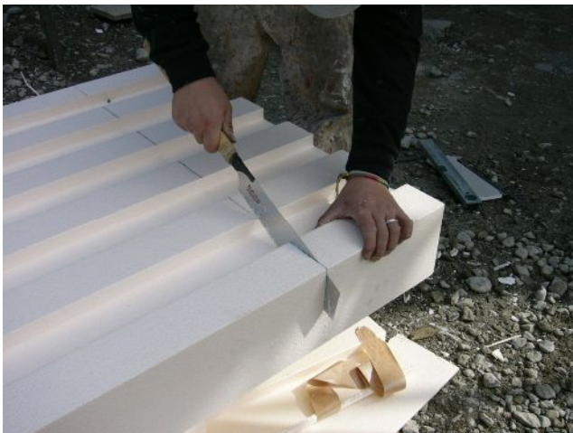
発泡スチロールだから、現場でのこぎりで切って、寸法調整しています。墨を付け簡単に切れます。
